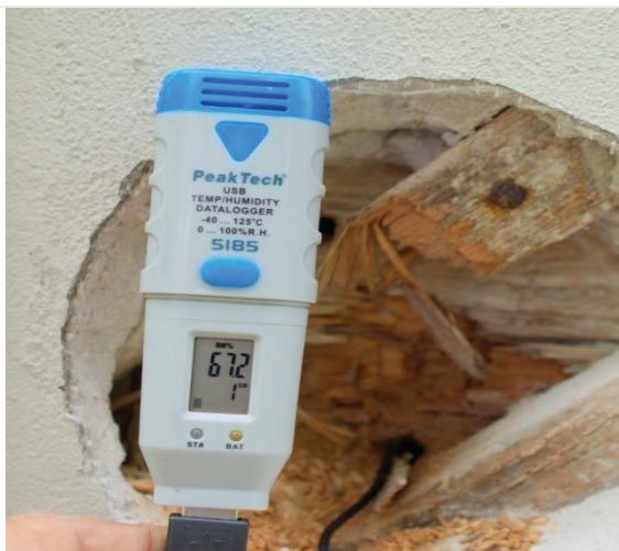
Zd. nr 41. Odkrywka nr 7. Zbadano wilgotność wewnątrz belki (bali) drewnianych na głębokości 15 cm. Wynosząca ca. 67,2% wilgotności masowej.
