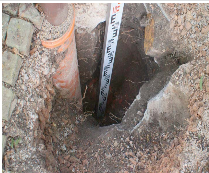
Zd.nr 2.Opis jak obok oraz widoczne korzenie roślin w strukturze fundamentów.
