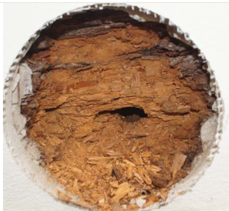
Zd.nr 19.Odkrywka nr 4.Destrukcja całkowita bala drewnianego podwaliny spowodowana brunatnym rozkładem drewna.
