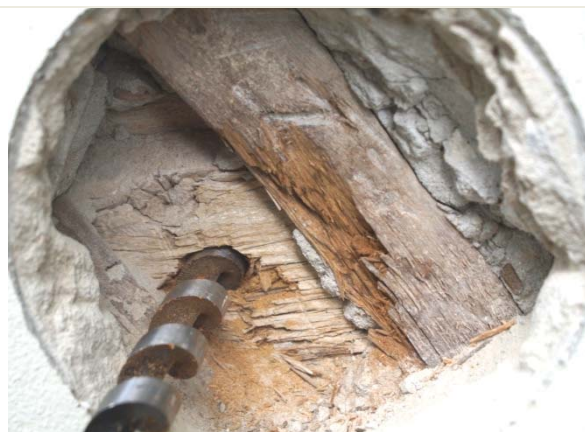
Zd. 28. Odkrywka nr 5. Miejsce wykonanej odkrywki nr 5 od strony południowej budynku. Po zdemontowaniu tynku cienkowarstwowego odkryto element bala drewnianego. W balu (wieńcu) nawiercono otwór na głębokość 15 cm. Stwierdzono występowanie całkowitego brunatnego rozkładu drewna na głębokości od 3 do max 5cm, w miarę pogłębiania otworu destrukcja biologiczna zmniejsza się. Można to stwierdzić po widocznych wywiercinach. Widoczna łąta drewniana 3,00x3,00cm. W celu wyrównania powierzchni ściany wykonano na balach pomiędzy listwami widoczny na zdjęciu historyczny tynk wapienny grubowarstwowy średnio 3,00 cm do 5,00 cm na, który nałożono tynk współczesny cienkowarstwowy gr. ca 5mm.
