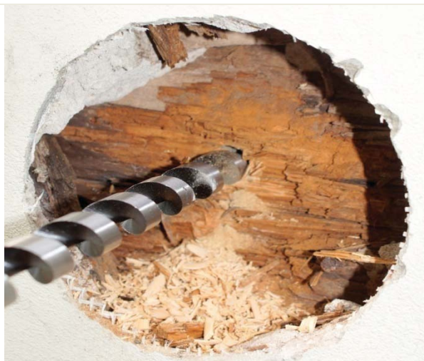
Zd.nr 12. Odkrywka nr 3. Miejsce wykonanej odkrywki nr 3 od strony wschodniej budynku. Po zdemontowaniu tynku cienkowarstwowego odkryto element bala drewnianego. W balu nawiercono otwór na głębokość 15 cm. Stwierdzono występowanie całkowitego brunatnego rozkładu drewna na głębokości od 3cm do max 5cm, w miarę pogłębiania otworu destrukcja biologiczna zmniejsza się. Można to stwierdzić po widocznych wywiercinach.
