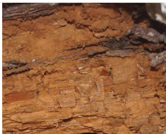
Zd.nr 22. Odkrywka nr 4. Próbka badanej podwaliny widoczny całkowity brunatny rozkład drewna w przekroju poprzecznym badanej belki.
