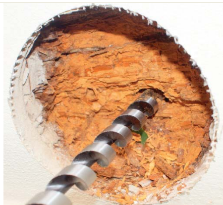
Zd.nr 20. Odkrywka nr 4. W wykonanej odkrywce wywiercono otwór o średnicy 10 mm na głębokość 15 cm w balu drewnianym. Stwierdzono, że brunatny rozkład drewna w miejscu badanym występuje na całej badanej głębokości. Można stwierdzić, że brunatny rozkład drewna występuje w całym przekroju poprzecznym belki (wieńca). Przykładem są widoczne wywierciny drewniane.
