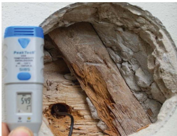
Zd.nr 29.Odkrywka nr 5.Zbadano wilgotność wewnątrz belki (bali) drewnianych na głębokości 15 cm. wynoszącą ca.54,90% wilgotności masowej.
