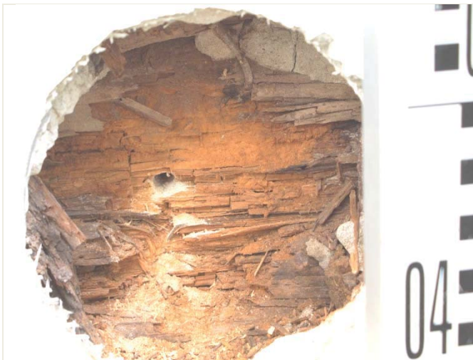
Zd.nr 11. Odkrywka nr 3. Destrakcja miejscowa bali drewnianych spowodowana brunatnym rozkładem drewna, zniszczenie tkanki drzewnej głównie w partiach obwodowych zawierających drewno bielaste. Listwa dystansowa drewniana ukośna 3,0cmx3,0cm uległa całkowitej destrukcji spowodowanej korozją biologiczną. Widoczny gwóźdź stalowy mocujący listwę, który także uległ korozji wżerowej.
