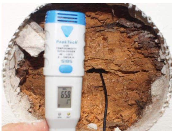
Zd.nr 21.Odkrywka nr 4.Zbadano wilgotność wewnątrz belki (bali) drewnianych na głębokości 15 cm. Wynoszącą ca.65,8% wilgotności masowej.
