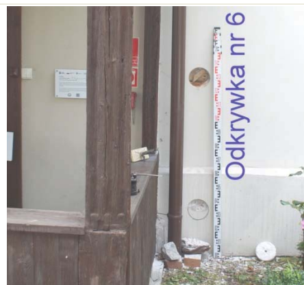
Zd. nr 32.Szczegół.Opis jak obok. Poniżej odkrywki nr 6 dobudowano do ściany konstrukcji drewnianej cokół betonowy wysokości 65cm oraz gr.ca. 5 cm.
