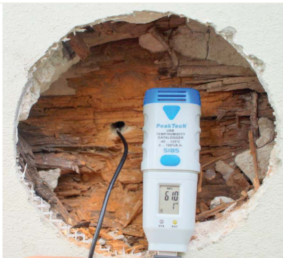
Zd.nr 13. Odkrywka nr 3. Zbadano wilgotność wewnątrz belki (bali) drewnianych na głębokości 15 cm. Wynoszącą ca. 61% wilgotności masowej.
