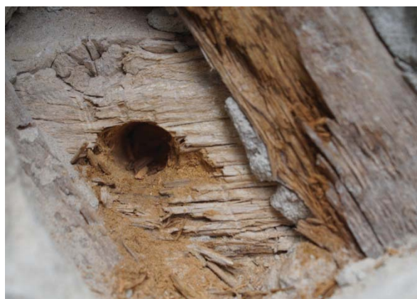
Zd. nr 27. Odkrywka nr 5. Destrukcja miejscowa bali drewnianych spowodowana brunatnym rozkładem drewna. Powierzchnia łuszczy się i kruszy.
